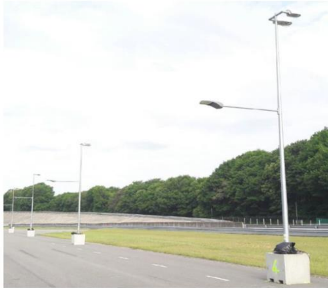
水泥燈柱配置
