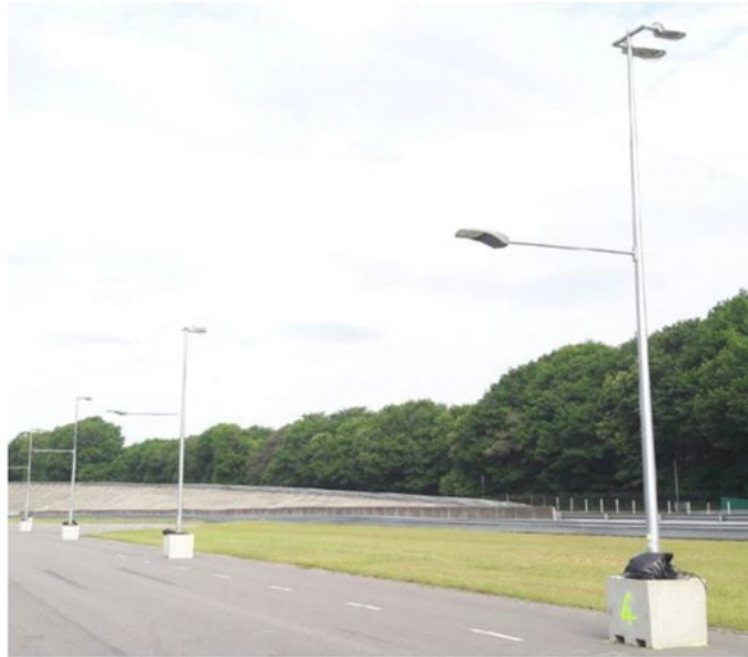
水泥燈柱配置
